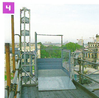
Žárově zinkované elektricky jištěné patrové bezpečnostní zařízení s mechanicky uzavíratelnými zásuvnými dveřmi, stejně jako integrované ovládání, zajišťuje bezpečnost místa vykládky.
